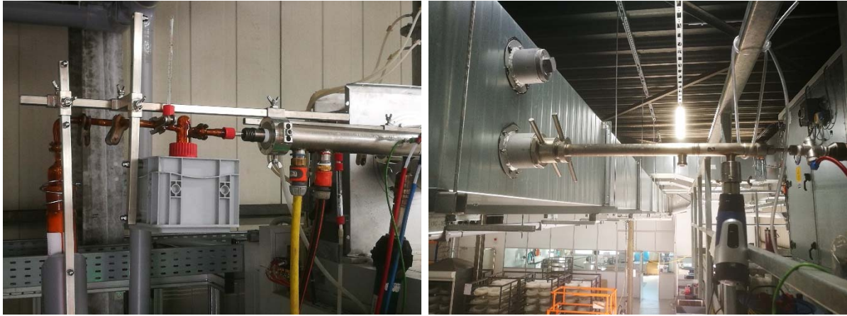
Abb. 1: Entnahme von Prozessgas zur Behandlung in den nachgeschalteten Versuchsanlagen. Hinter Temperofen (links), aus dem Sammelkanal nach Frischluftzufuhr (rechts).
