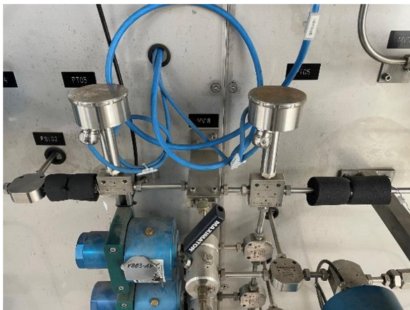
Abbildung 7: Nachgerüstete Messstellen 6-7 an der Schalttafel
