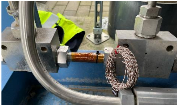
Abbildung 6 Nachgerüstete Messstellen 1-5 am Verdichter
