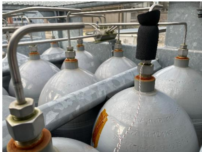
Abbildung 9: Nachgerüstete Messstellen 14-17 am Mitteldruckspeicher (Segmente 4-5)
