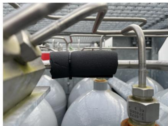
(b) Isolierte Messstelle
